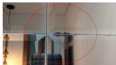
Corrosão por danos na borda e consequentemente na camada protetora.
